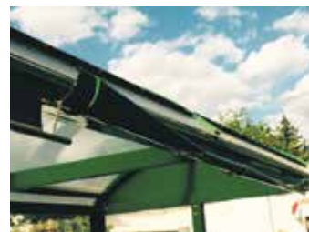
A leszakadt ereszcsonatáért nem tudni pontosan ki a felelős
