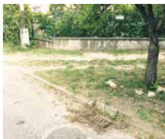
A Bajtárs u. 24-gyel szemben lévő rácsos víznyelő helyreállítása szükséges
