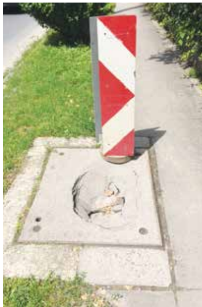
Fóti út 22. előtt beszakadt aknafedél
